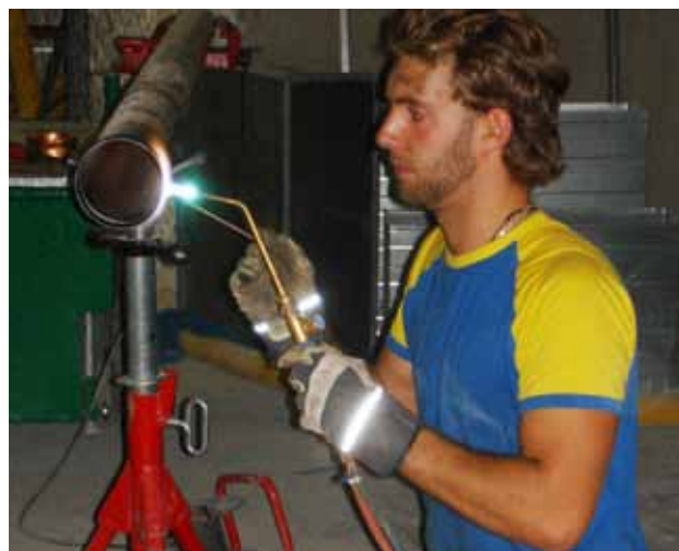
Vid lödning av kopparrör bildas kolmonoxid.
